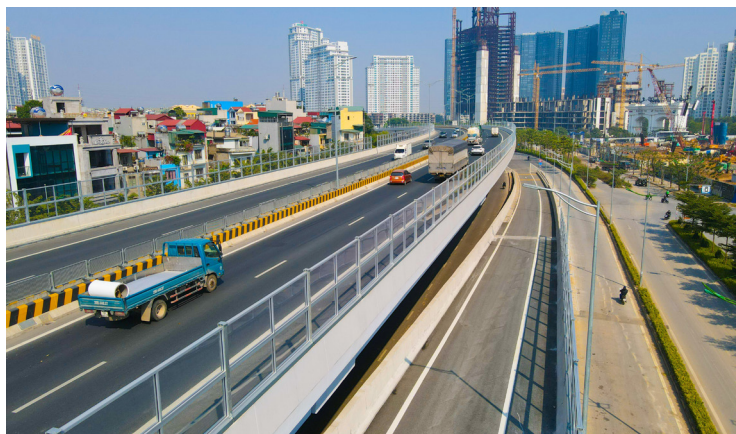
Đường vành đai 2 và vành đai 3 trên cao (Hà Nội): Sản xuất và thi công tường chống ồn phân âm (tấm trong suốt)
