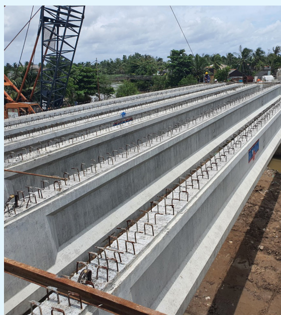
Dự án Quốc lộ 53 (Trà Vinh) Thi công xây mới 2 cầu; thi công sửa chữa 5 cầu và công trình an toàn giao thông
